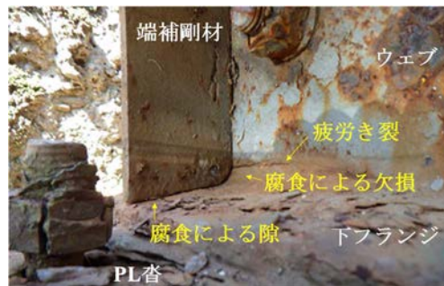
図 1 I ビーム橋の疲労き裂事例
