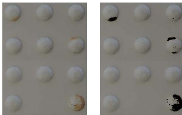
(a)変色したボルト部 (b)変色部を選択 図-3 画像解析における塗膜変状部の選択
