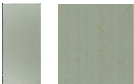
図-4 8ヶ月後のA_N_1 (左)と中心部の点錆 (右)
