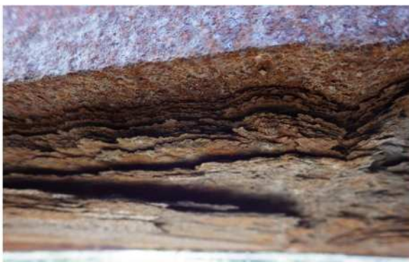
図-1 異常層状さびの発生状況
