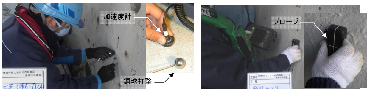
写真2 測定状況（左：衝撃弾性波法（かぶりコンクリートはく離状況），右：電磁誘導法（かぶり深さ））
