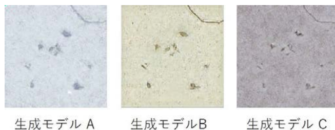
図-1 生成モデルの疑似ひび割れ画像生成例
