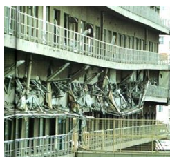
神戸西病院の被害 図8 層間破壊の例
