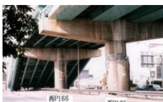
西 P166 (軽傷) と西 P165 (破壊), 西 P167 柱は崩壊-落橋 図4 1基挟んでの破壊例
