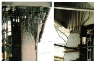
(a) P465 山側 (b) P472 海側 引張破壊の例 図2 橋脚の孤立的破壊例(1)
