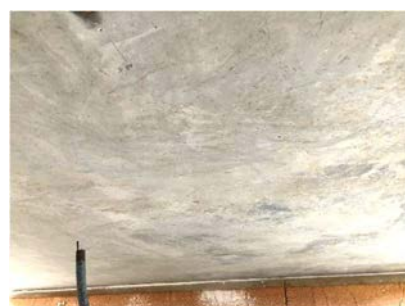
写真-4 加熱試験後の床版上面
