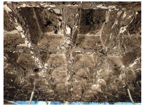
写真-3 加熱による床版下面の変状
