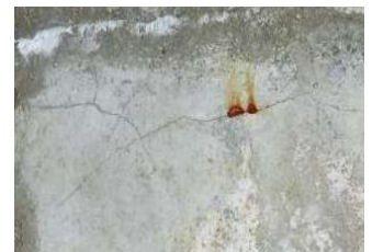
図-2 PCM の錆汁状況
