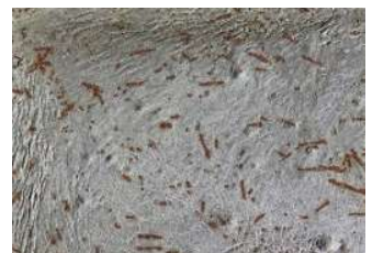
図-3 UHPFRC の腐食状況
