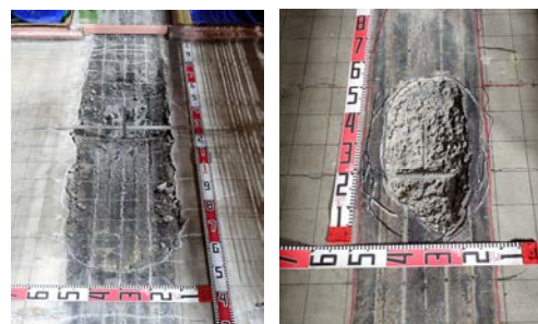
写真-1 補強後の砂利化(ポットホール)
