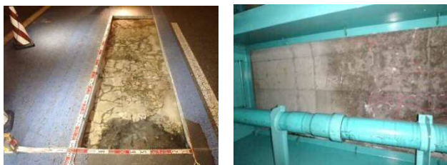
写真-1 床版上下面の損傷状況
