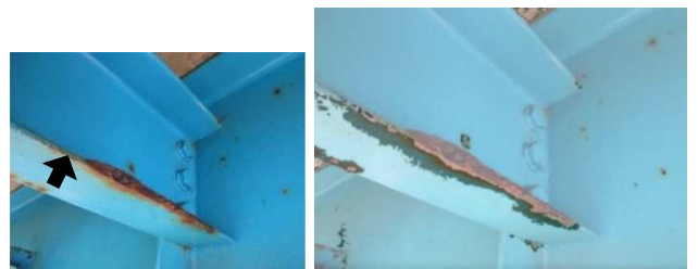
図3 ソフトによる桁の錆状況抽出
