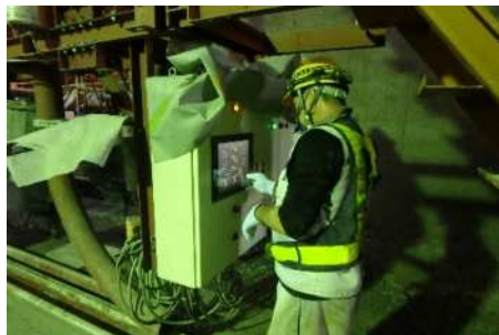
写真-3 制御盤の操作状況
