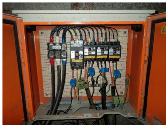
図-3 分電盤内設置状況
