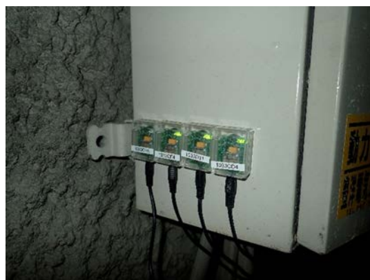
図-2 電力センサー設置状況
