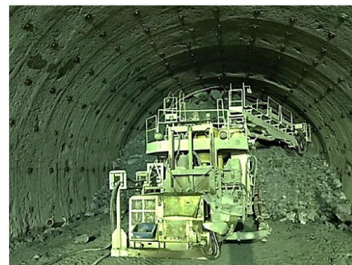
写真-1 切羽の崩落状況
