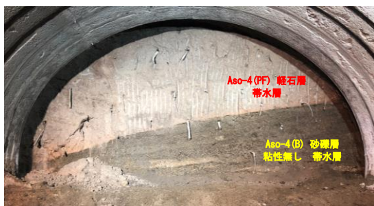
図-2 変状区間の代表切羽写真 (TD=459m地点)
