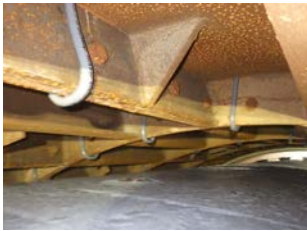
写真-4 エア抜きパイプ
