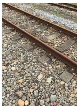
図10 バラストの盛り上がり/崩れ現場写真
