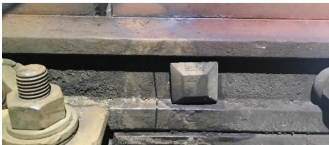
図 6 継目板亀裂の人工欠陥例
