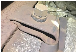
図 5 締結ボルト緩みの人工欠陥例
