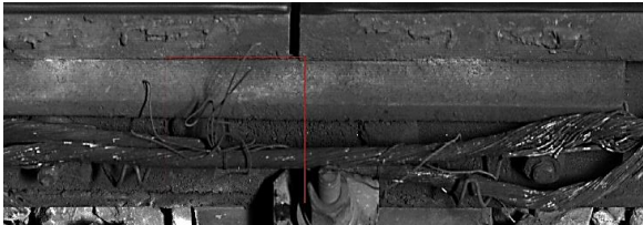
図 8 継目板亀裂の誤検知例 (レールボンド素線切れ)
