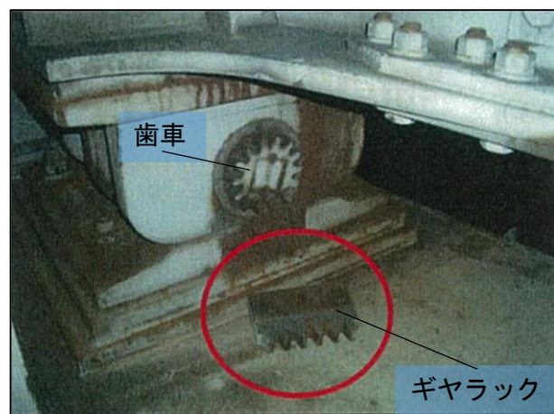
写真-1.1 ラックボルトの折損
