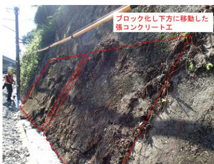
写真-1 張コンの被災状況(下部張コン)
