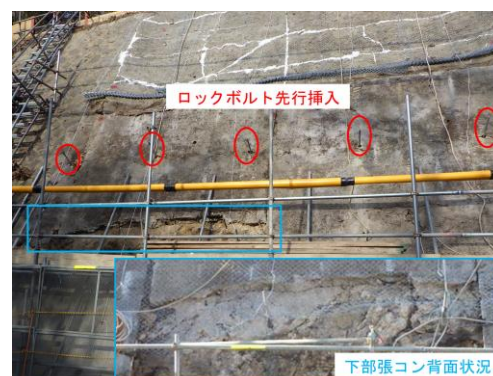
写真-2 張コンと地山の定着状況
