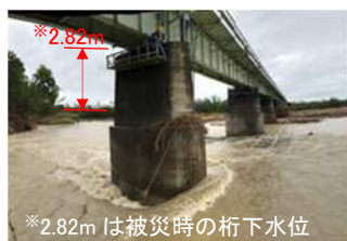
写真-1 被災状況
