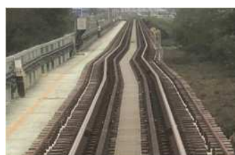
写真-2 軌道変位状況
