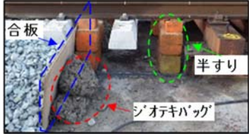
写真-3 仮受及び道床の流出
