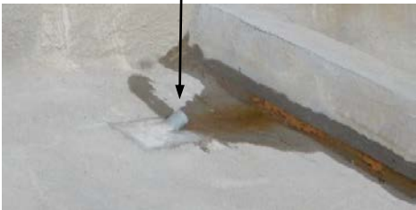
写真 1 打込み式の水抜きパイプ
