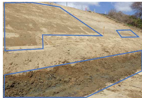
写真1 のり枠工基面の湧水状況
