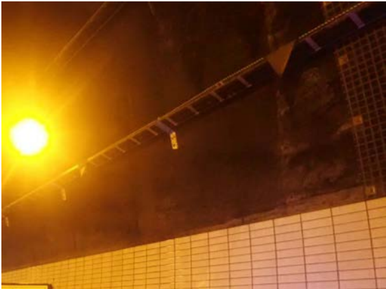
写真-2 黒く汚れた区間
