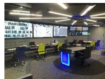
図-7 中央監視室
