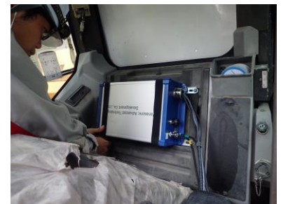
図-2 小型制御盤
