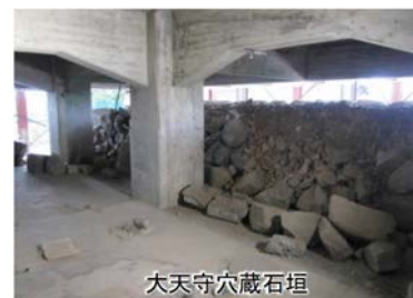
写真-3 崩落状況2
