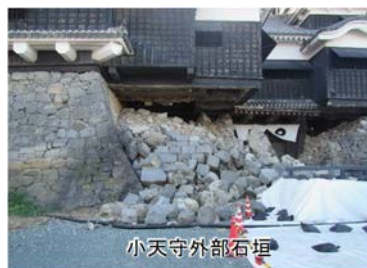
写真-2 崩落状況1
