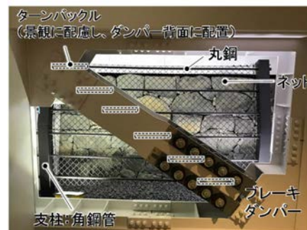
写真-4 落石防護柵
