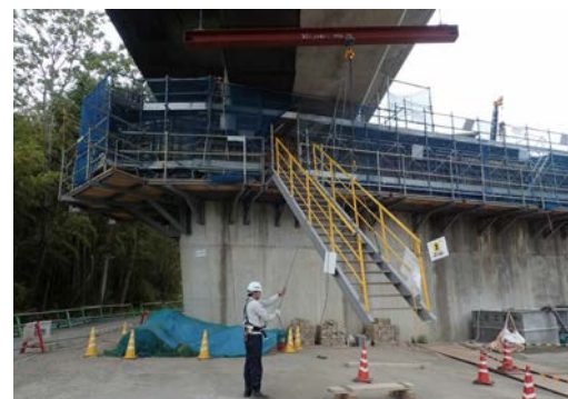
写真-3 跳ね上げ式昇降設備
