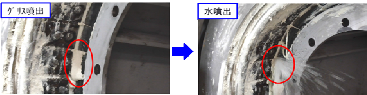
写真－2 ブラシ間からの漏出状況
