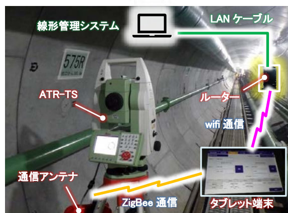
図-1 シールド坑内自動測量システム
