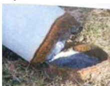
写真-2 倒壊事例 2)
