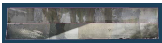
(a) 細分化前の橋台面
