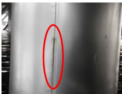
写真3 溶接部近傍の軽微な腐食
