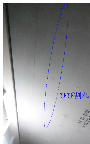
図-5(2) PCa床版の長辺並行方向のひび割れ
