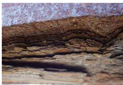
写真-2 層状剥離さび
