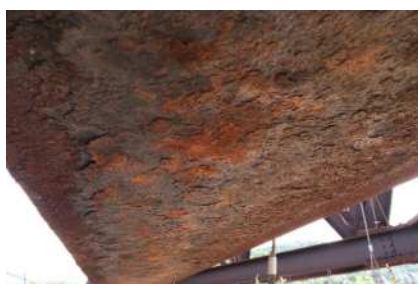
写真-1 下弦材下面腐食状況
