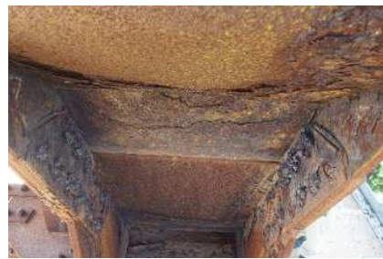
写真-3 格点部斜材腐食状況
