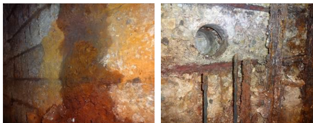
写真-3 壁漏水部
