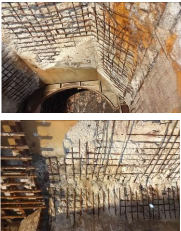
写真-1 煙道劣化状況 (煉瓦撤去後)
