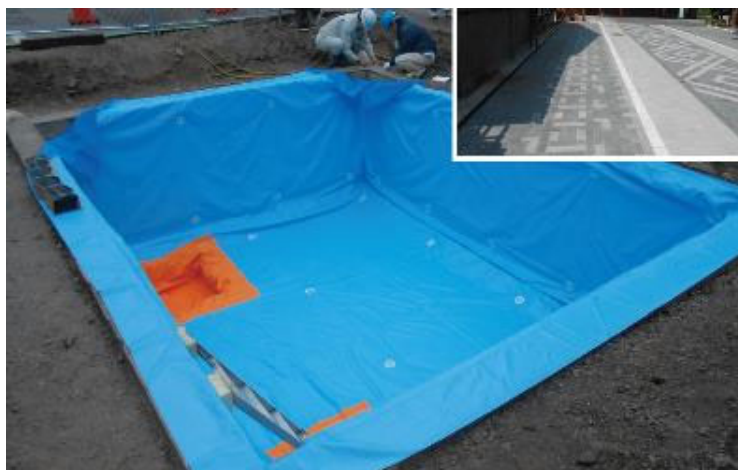
写真2 オープン式防火水槽への設置例
