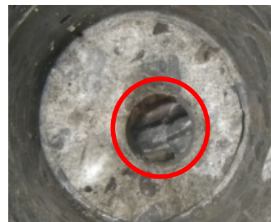
写真-1 グラウト充填不足
