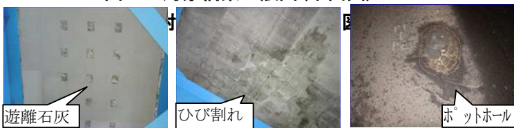
写 1 既設床版の損傷状況
