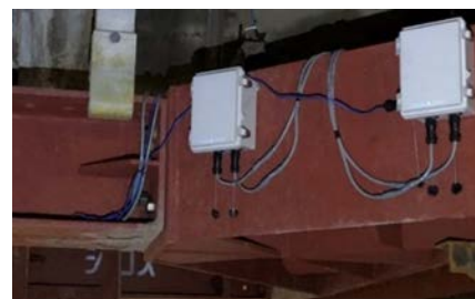
図-3 子機設置状況
