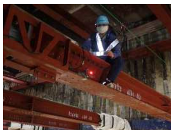
写真－4 センサー設置状況
