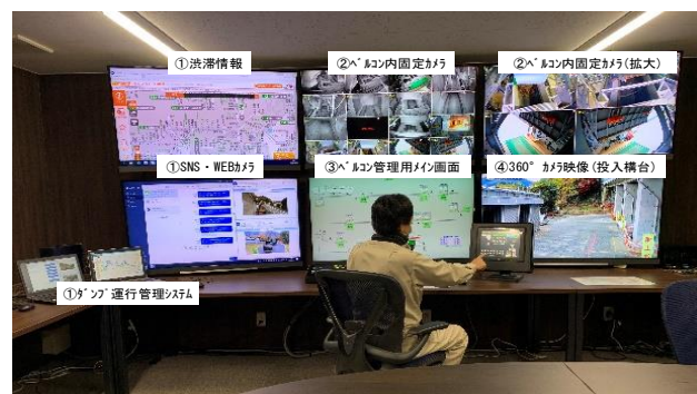
写真-1 ベルトコンベヤ操作室
