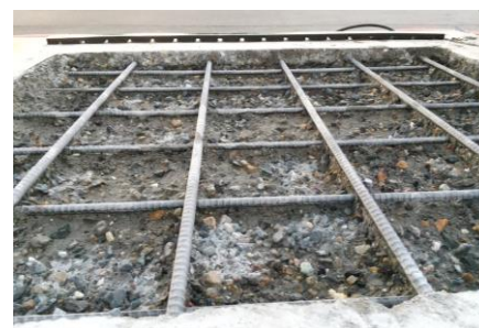
写真-5 はつり面の状況
