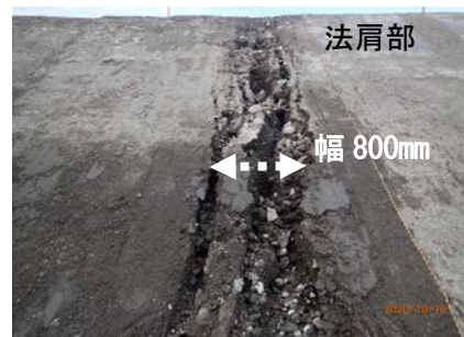
図-3 試験 16 日後の未散布区の侵食状況
