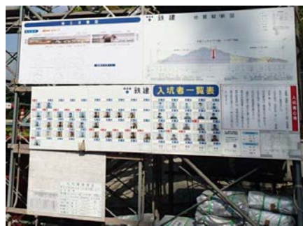
写真-1 入出坑者表示板の例
