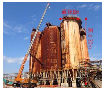
写真-1 大型円筒形タンク
