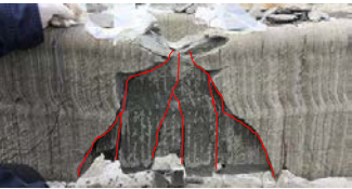
図-7 M-3 ひび割れ確認状況
